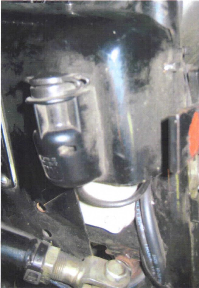
Bordsteckdose mit Normstecker rechts
